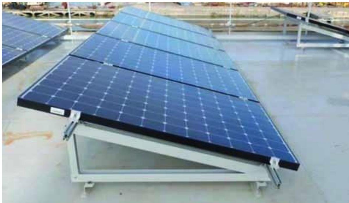
Рис. 2. Панели солнечных батарей
