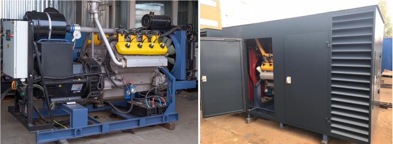
Рис. 7. Газопоршневая электростанция ЭГП-100. Общий вид и установка во всепогодном металлическом кожухе
