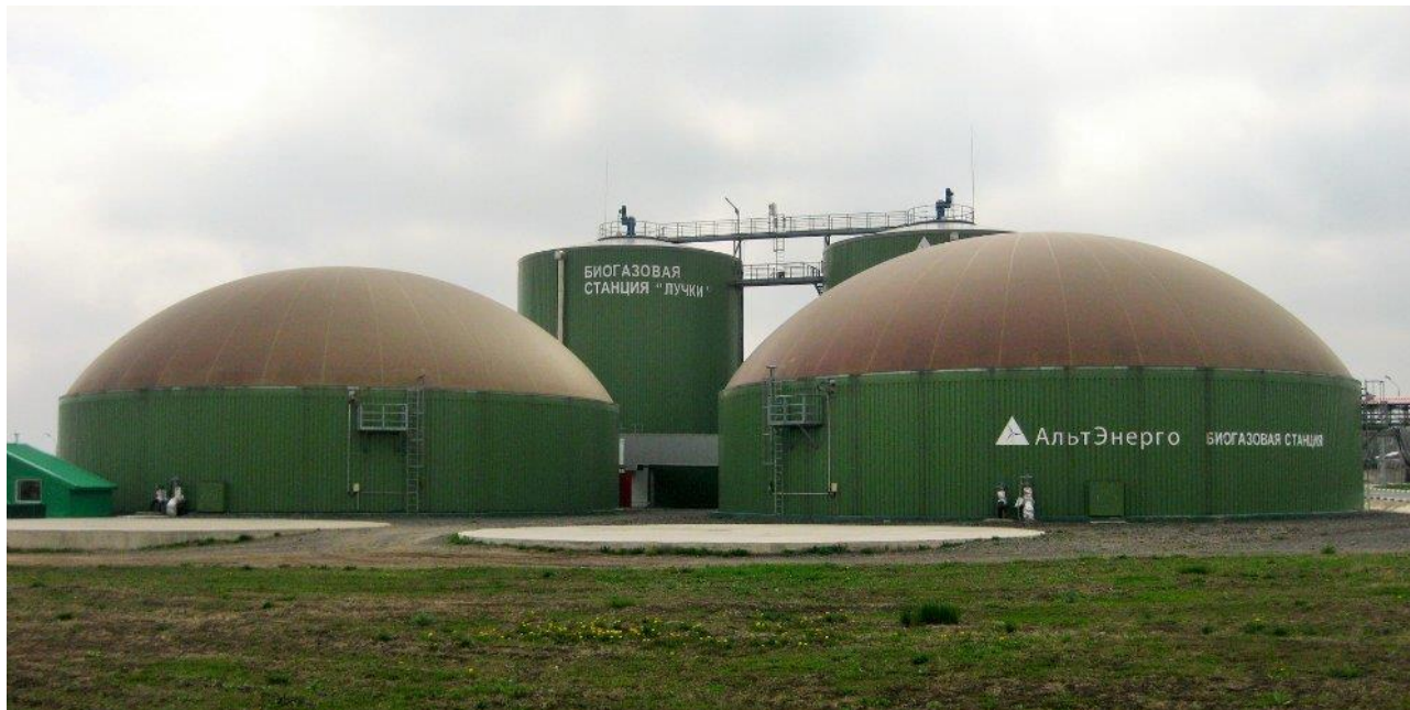
Рис. 4. Биогазовая электростанция «Лучки», Прохоровский район, Белгородская область, Россия
